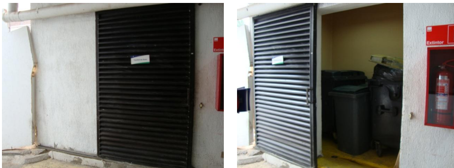
FIG.5 SALA DE ALMACENAMIENTO FINAL (RSD Y ESPECIALES SIN REFRIGERACIÓN)
