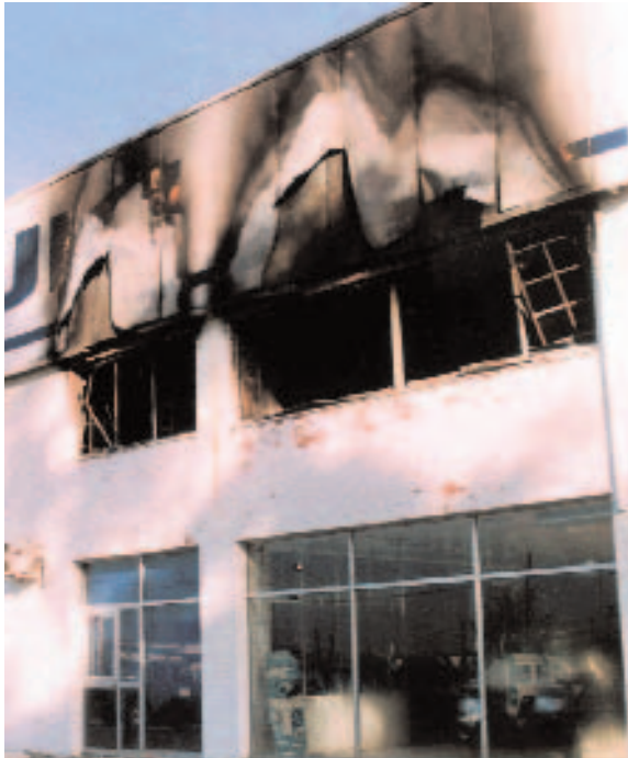
Fachada exterior de un edificio siniestrado sobre la que se observan líneas de demarcación generadas por los efectos de las llamas, el calor y el humo
