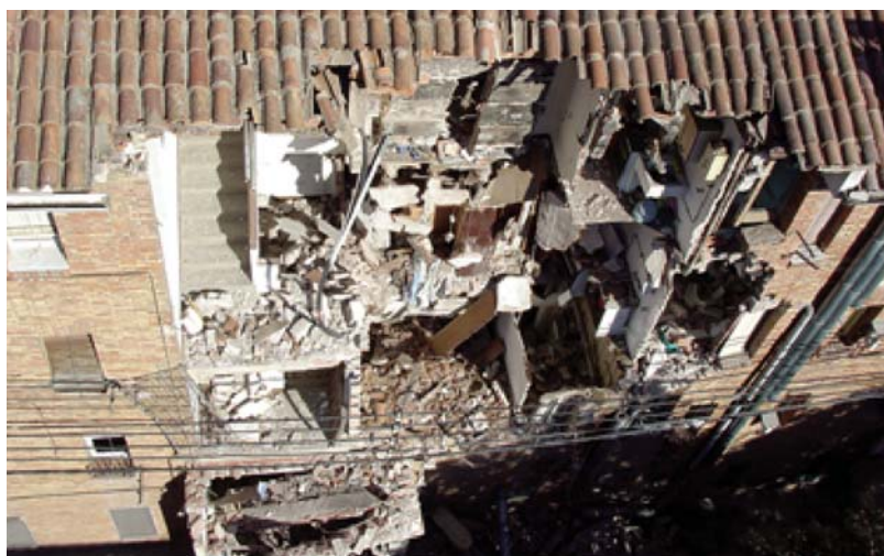
Los daños producidos por las deflagraciones de gas combustible se pueden ver agravados por el tipo de construcción utilizado.
