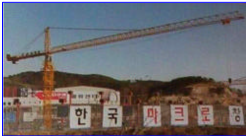
Grúa Torre Pluma Horizontal. Corea.
