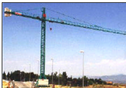
FIG. N°10. Grúa Torre Pluma horizontal.
