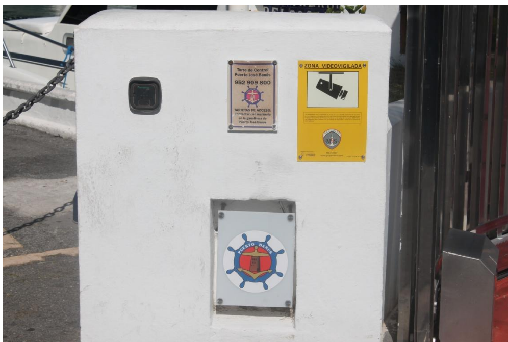
Señalización de cámaras de seguridad y lector de tarjetas para sólo personal autorizado
