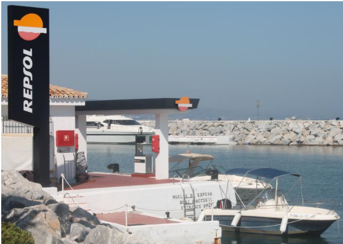
Estación de combustible donde se pueden apreciar los sistemas antiincendios
