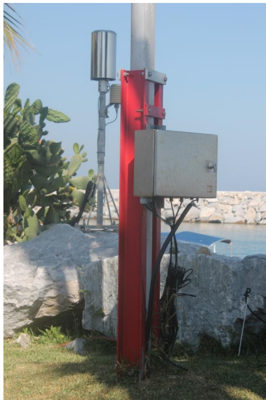
Cableado eléctrico, gran parte a la intemperie
