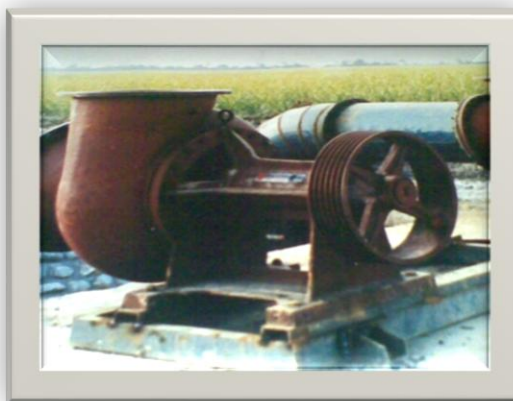
Fotografía 8: Bombas de agua.
