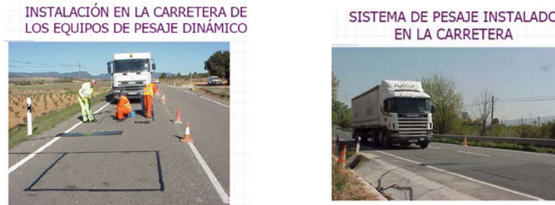
Figura N° 4-39 Sistemas de Pesaje en Movimiento
